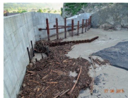
Beim Gewitter vom 6. Juni 2015 bewahrte der neue Geschiebesammler die Gemeinde Giswil vor grösseren Überschwemmungen und Schäden.
