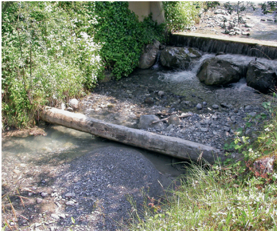
Diverse Holzsperrren sind unterspült und erfüllen ihre Sicherheitsfunktion nicht mehr.
